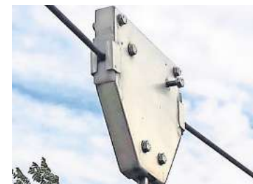
Spielplatz Bertha-von-Suttner-Straße: Diese Schraube an der Seilbahn-Aufhängung hat jemand herausgedreht. FOTO: STADT SARSTEDT
